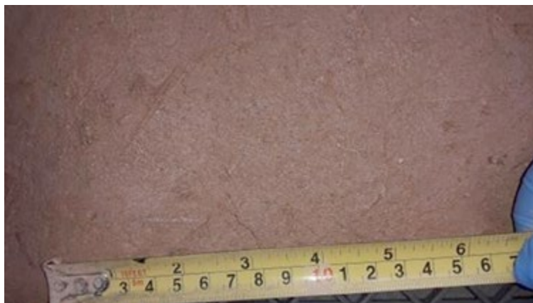
Figura 2. Fisuración en los prototipos.
