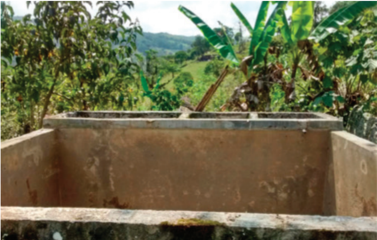
Figura 1. Tanque de almacenamiento
