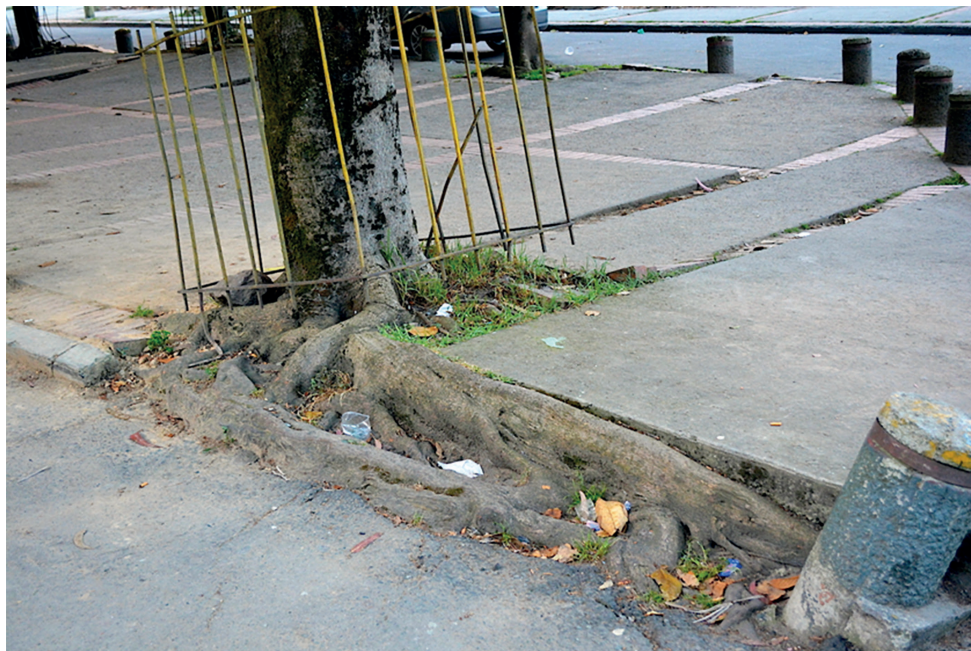
Figura 3. Daños por F. tequendamae . Plazoleta frente a la Quinta de Bolívar. Bogotá. Fuente: elaboración propia.
